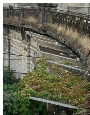
La barrière du pont des Amours est en très mauvais état.
